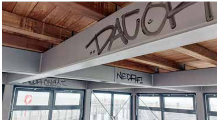
Die Sachbeschädigung an der neuen Mittelbrücke Fotos: Stadt Wyk/Andreas Hansen
